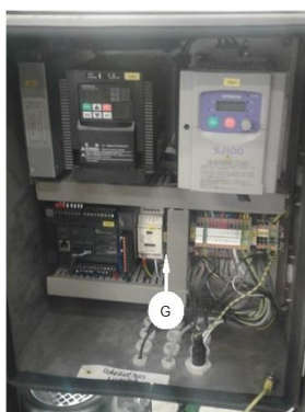
Фиг. 8.3 Стекланный предохранитель G в электрошкафу опрыскивающей установки
