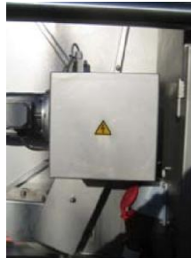
Предупреждающий знак на кожухе коллектора
